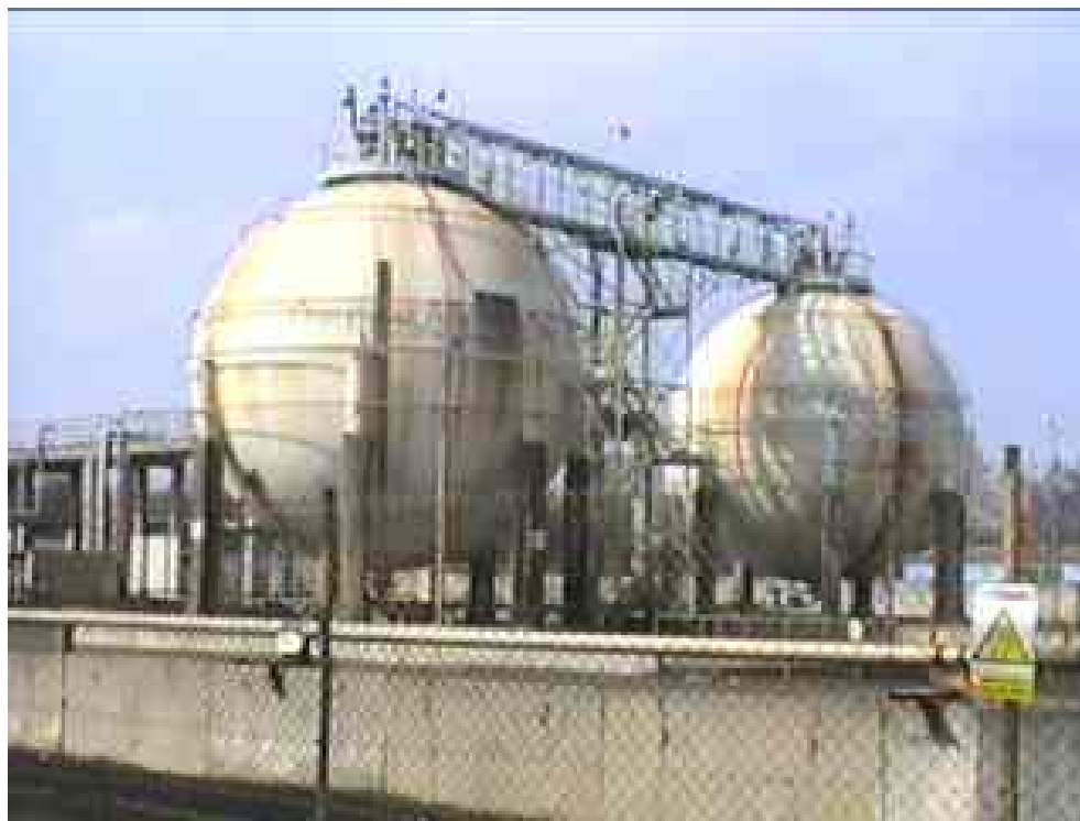
Obrázek č. 21 Kulové nádrže na skladování zkapalněných plynů
