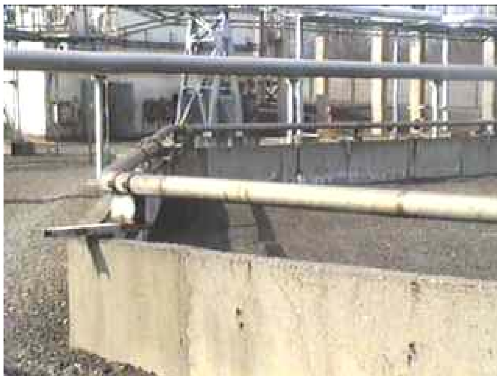
Obrázek č.5 Pohled na potrubí parních clon u zásobníku se zkapalněným plynem
