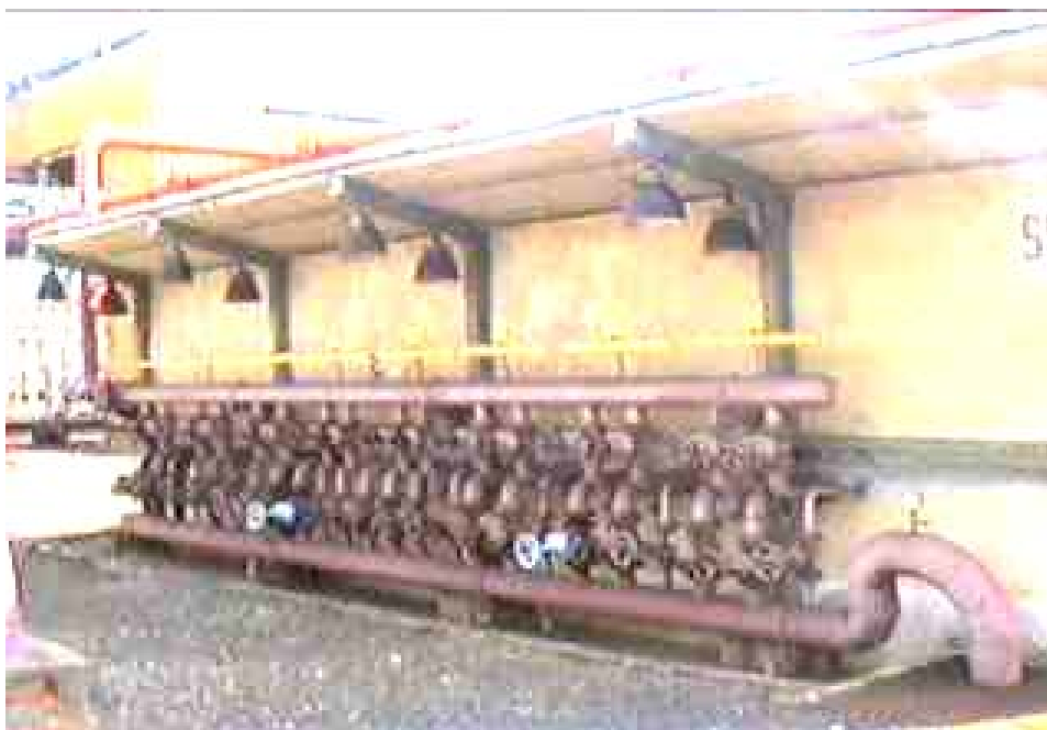
Obrázek č.4 Požární štít s ovládáním stabilního hasicího zařízení skladu hořlavých kapalin
