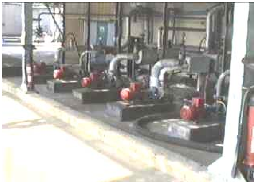
Obrázek č. 17 Čerpací stanice s čerpadly na hořlavé kapaliny umístěnými v záchytné jímce
