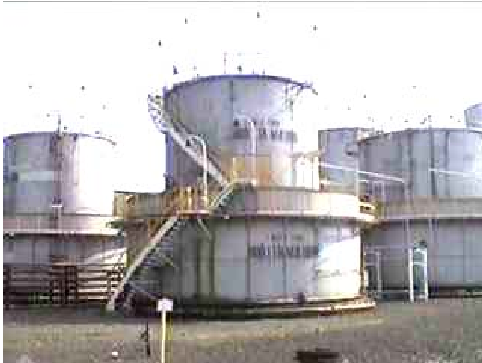
Obrázek č. 3 - Nadzemní nádrže na skladování hořlavých kapalin
