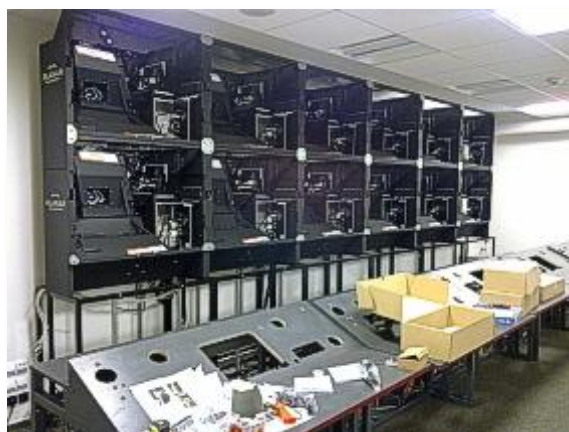
Instalace videostěny na operačním středisku MP Ostrava
